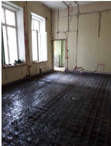
Foto 7. Aadressil Lai 40 asuvas majas valati renoveerimise käigus tulevase sammaltaimede ja vetikate hooldaruumile uus betoonpõrand. Edaspidi on ruumi plaanis paigaldada relssidel liikuvad kompaktorkapid. Foto: Kai Vellak.
